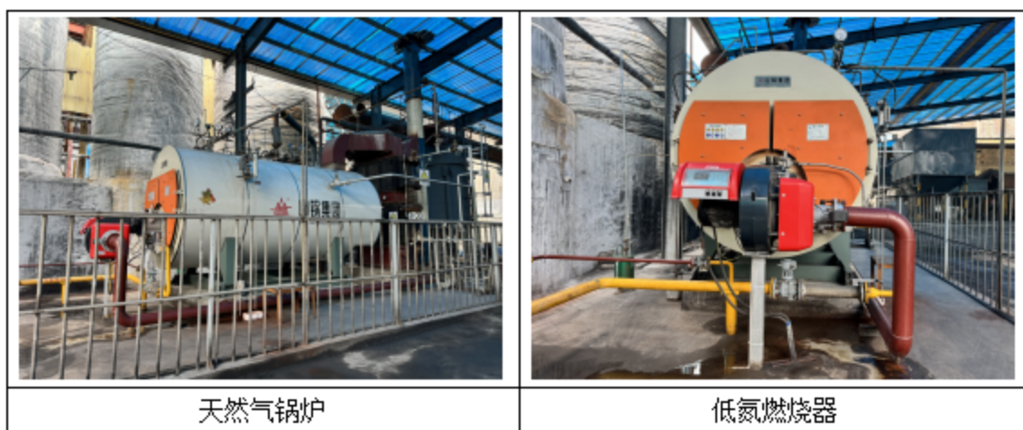
图 4.1-1 废气治理设施
