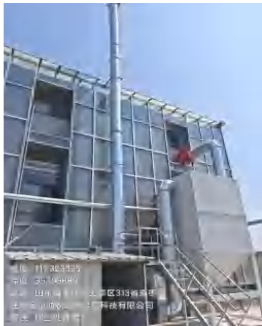
袋式除尘器及排气筒（DA002）
