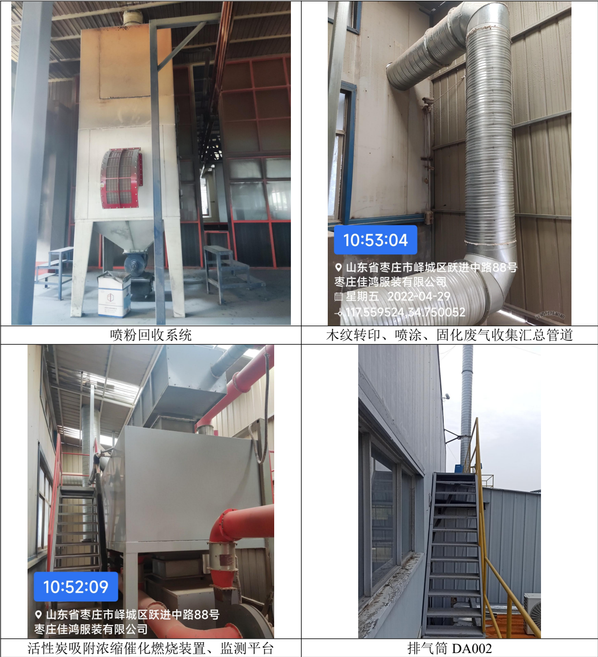
图 4.1-1 废气治理设施
